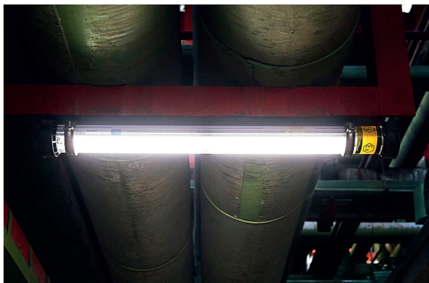
Räjähdysvaarallisten tilojen valaisimien tulee olla Ex-merkittyjä ja täyttää asennusympäristönsä ATEX-vaatimukset.
